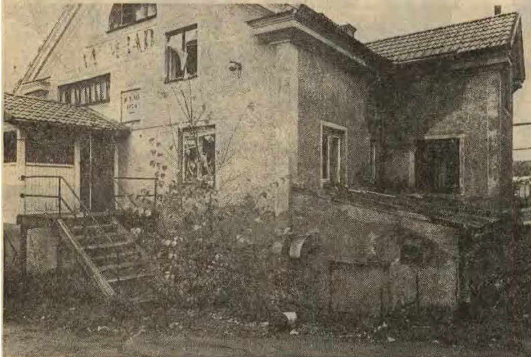
Inte ett fönster är helt i varmbadhuset. Möjligen ett som någon tagit hand om och placerat i sitt fritidshus
