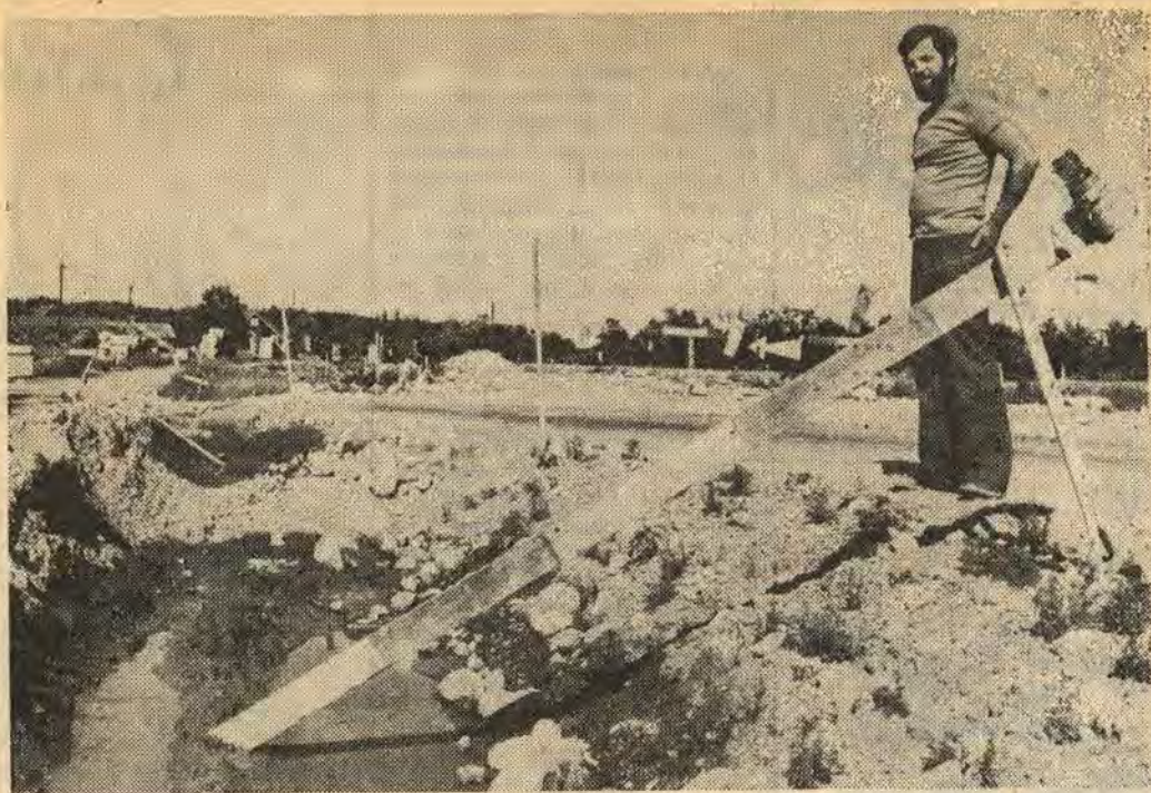
Jan Gustafsson bor utmed vägen mellan Kisa och Åtvidaberg, i Väsby någon mil från Kisa. I höstas började vägförvaltningen arbetet med att rätta ut vägen på en ca 300 meter lång och besvärlig bit förbi hans bostad. Men arbetet slutfördes inte. En trafikfarlig sträcka har blivit än värre, till stort förtret för dem som bor vid platsen
